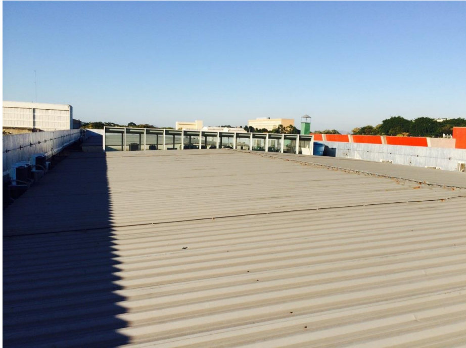
Figura 17. Telhado do CT2 da Cidade Universitária da UFRJ na Ilha do Fundão onde será instalado o sistema de ar condicionado solar.
