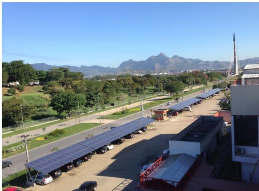
Figura 13: Sistema Fotovoltaico no estacionamento anexo ao LNDC.
