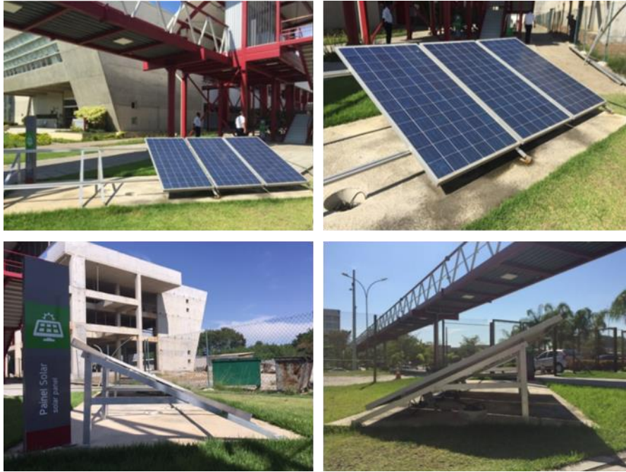
Figura 14: Sistema Fotovoltaico do MagLev.
